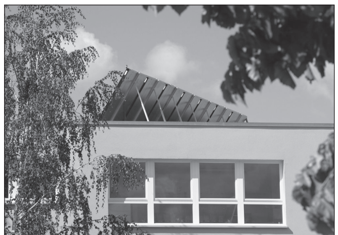
Abb. 19: Die thermische Solaranlage auf dem Dach der Kindertagesstätte „Sonnenschein“
